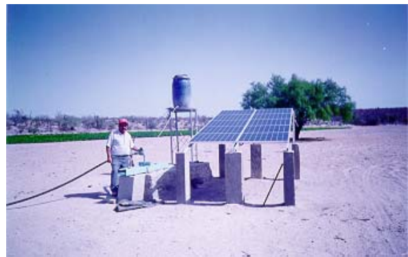
Figura 2: Sistema fotovoltaico de Bombeo de Agua en el Rancho Agua Blanca, BCS (no se muestra la pila)
