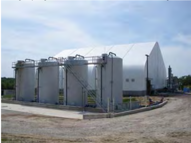
En primer plano los tanques con la solución de sales orgánicas, al fondo el biodigestor cubierto de 38 m x 38 m x 15 m de alto. Terrabon LLC, Bryan TX
