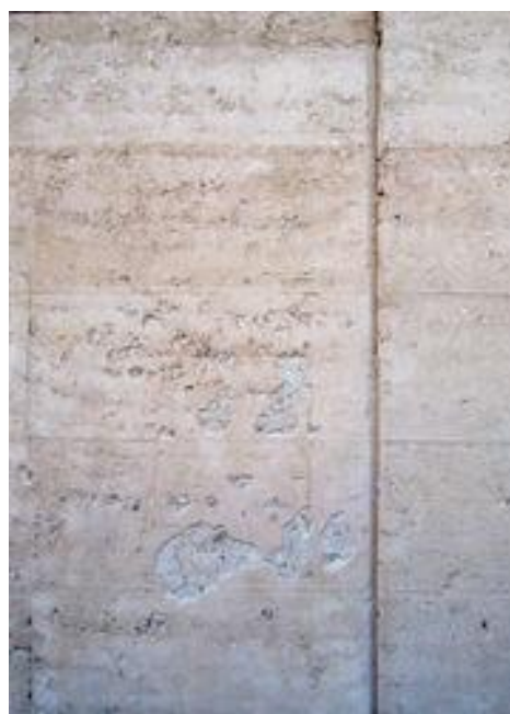
Figura 10: Detalle de un muro de tapia. Pueden observarse los parches y reparaciones realizadas así como la diferencia tonal en cada capa compactada. Foto copiada de Wikipedia, Rammed Earth, http://en.wikipedia.org/wiki/Rammed_earth
